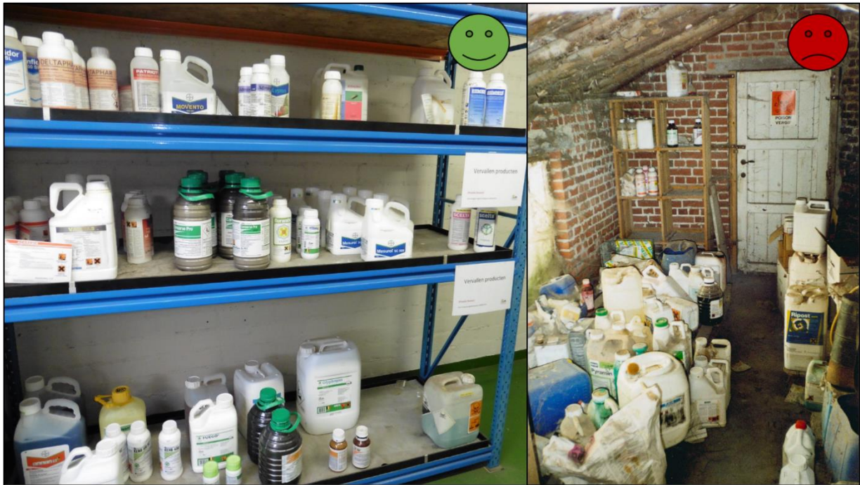
Figuur 1: Het fytolokaal links, met duidelijk geordende producten en legplanken met opstaande randen, beperkt de risico's en de kans op het maken van fouten. Het fytolokaal rechts vormt een gevaar voor de gebruiker van de producten en het milieu. Afbeelding: Preventagri.
